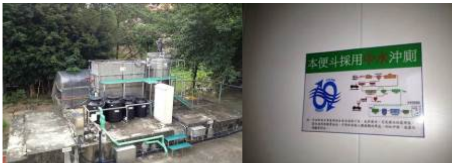
中水回收設施處理及設施實景
