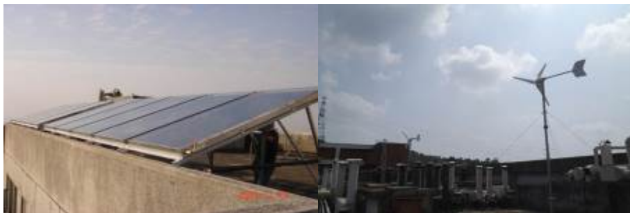
再生能源設置情形
